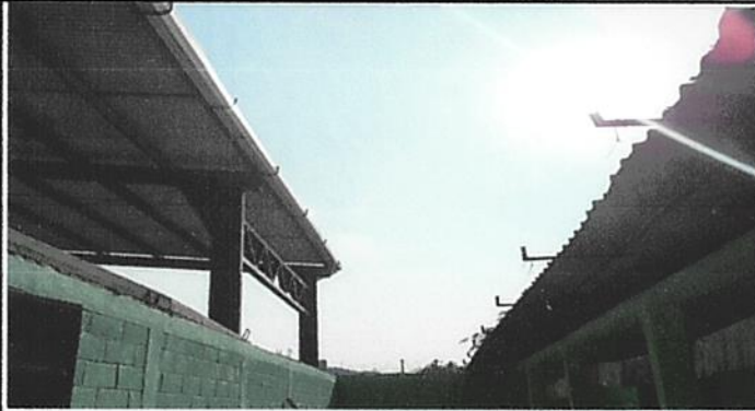
Foto 7: Las láminas están en proceso de instalación considerando que las mismas se encontraban en malas condiciones debido al deterioro y oxidación.
