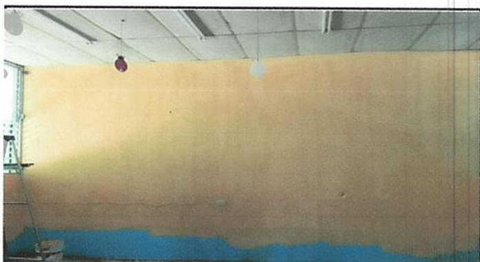
Foto 4: Las paredes se encuentran en proceso de pintarlas debido al deterioro de las mismas por la humedad por las lluvias.
